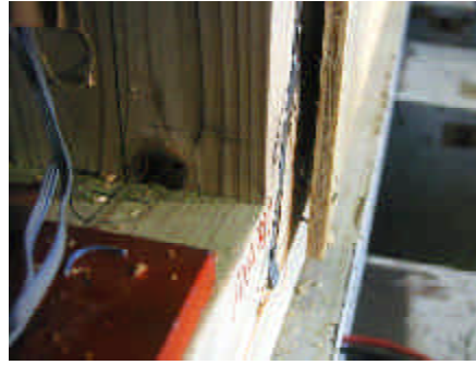
写真3 合板留め付け釘の抜け
