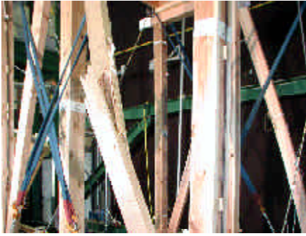
写真2 筋かいの折損
