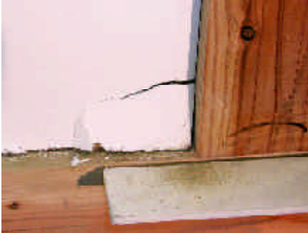
写真5 漆喰隅角部のひび割れ
