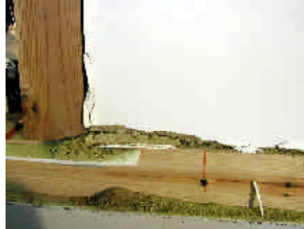
写真6 土壁隅角部の崩れ
