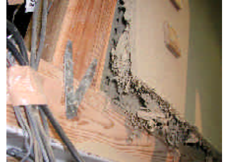
写真7 土壁の面外への剥離
