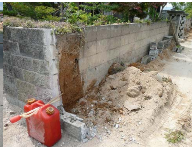
ブロック塀の倒壊
