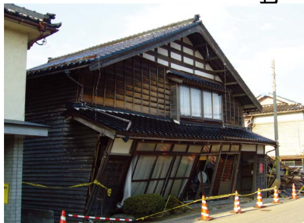
全壊と判定した建物 (2007年能登半島地震)
