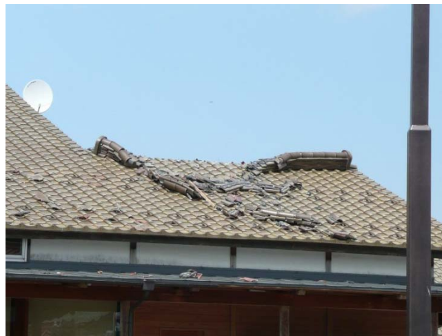
瓦屋根の落下
