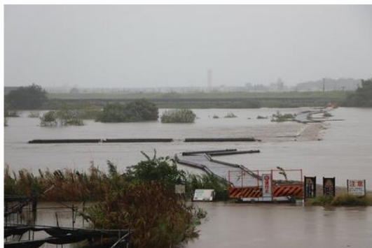
橋板や橋桁が外れた上津屋橋（流れ橋）＝15日午後3時56分、八幡市上津屋
